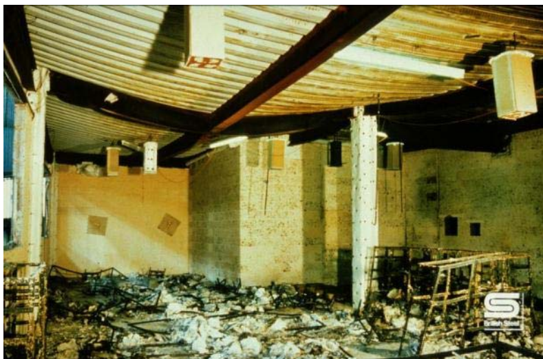
Průhyb stropnice 640 mm
