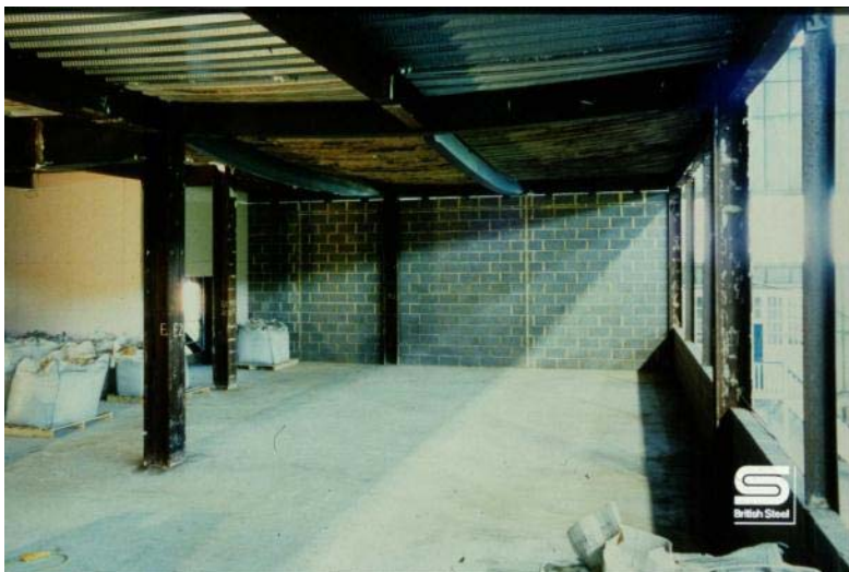
Deformovaná stropní deska
