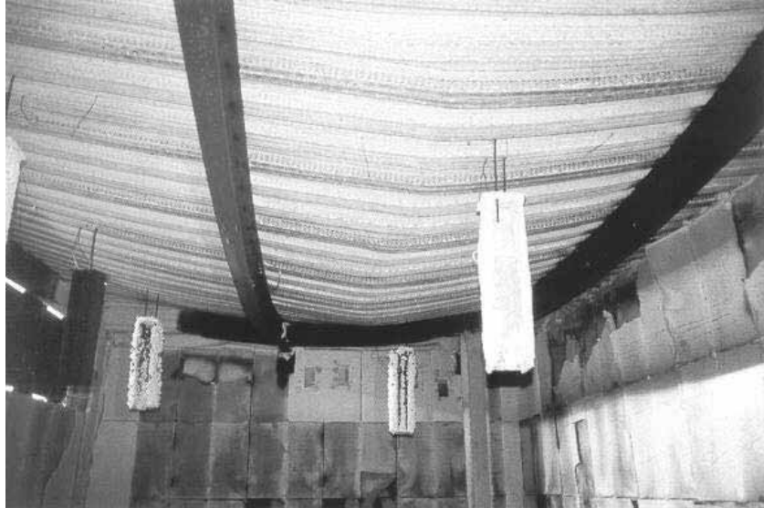
Obr. 47 Deformace desky po požáru
