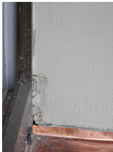
Obr.2.6 Promáčkнутá část ostění bez výztužné sítoviny
