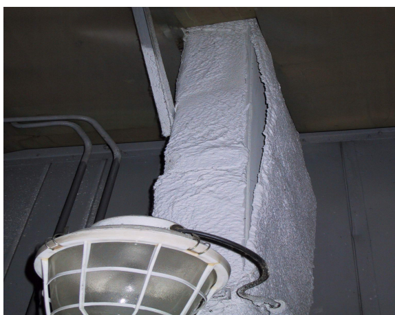
Obr.2.14 Odpadlý nástřik vlivem nedostatečné adheze k podkladu
