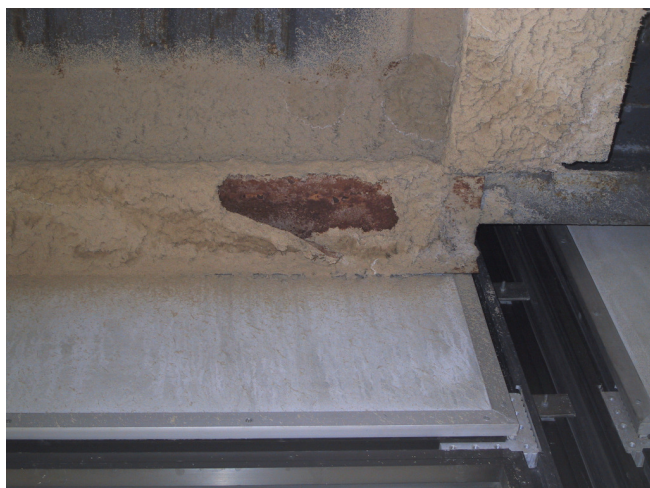
Obr. 2.9 Odpadlý nástřik v důsledku nesprávného zakotvení k podkladu bez primeru k ocelovému podkladu
