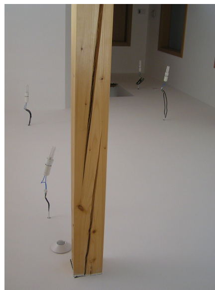
Obr.2.4 Dřevěný nosný sloupek v krovu nadměrně popraskaný
