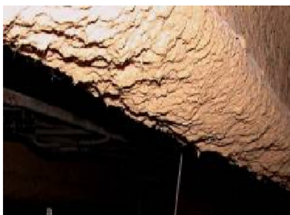
Obr.2.11 Nestejně nanesená vrstva nástřiku na stojině a přírubě ocelového nosníku nesprávně namíchaný a provedený nástřik
