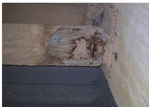
Obr.2.12 Zkorodovaný povrch ocelové příruby pod odpadlým nástřikem
