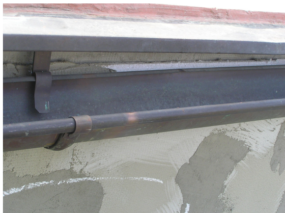
Obr.2.7 Obnažený pěnový polystyrén bez krycí stěrky
