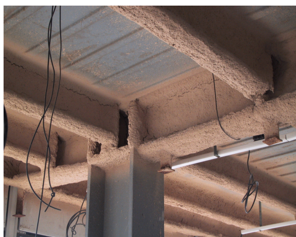
Obr. 2.13 Jemné praskliny v ocelové konstrukci opatřené nástřiky. Nestejně nanášená vrstva nástřiku na stojině a přírubě ocelového nosníku, nesprávně namíchaný a provedený nástřik
